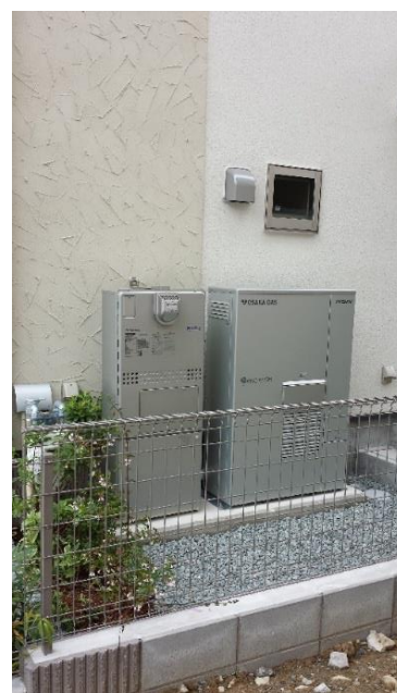
エネファーム導入部
