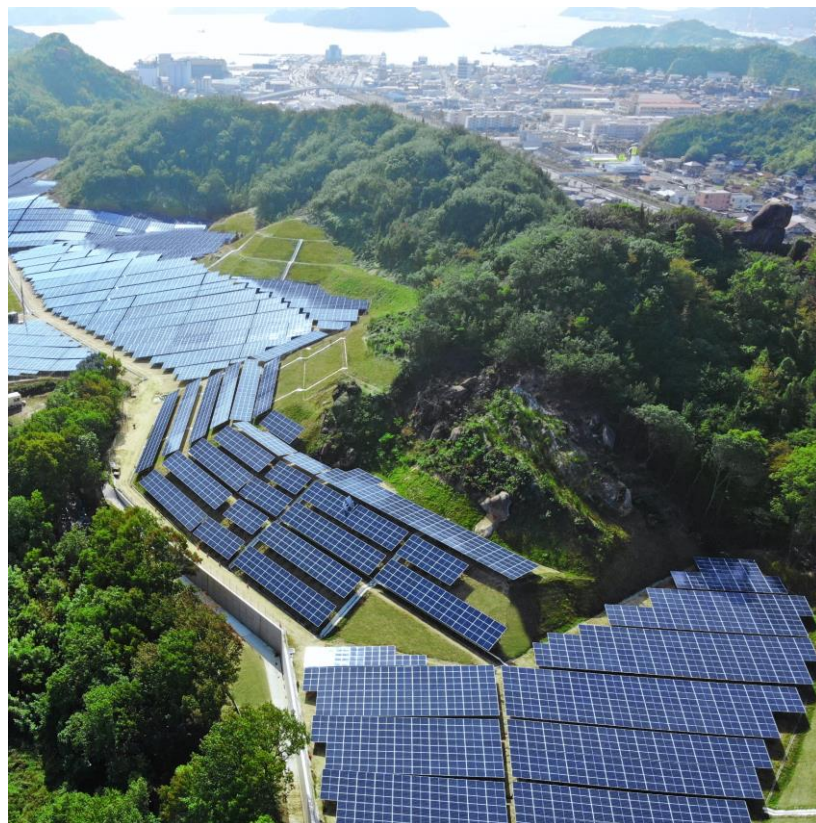
発電所空撮写真
