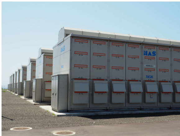
「リエネ松前風力発電所」 における蓄電池
